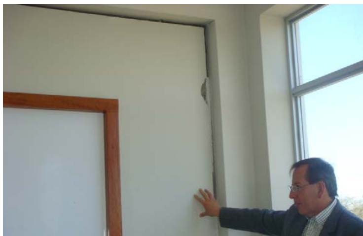
Figura 1.24 Inestabilidad de la mampostería 9
