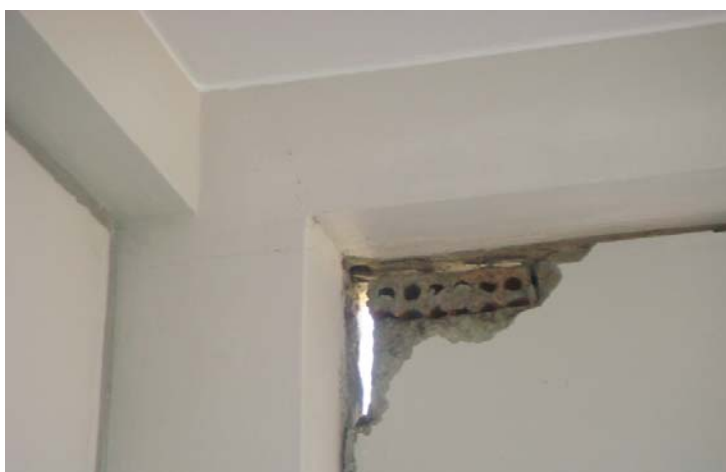
Figura 1.25 Fracturación de ladrillos en las esquinas de los tabiques 10
