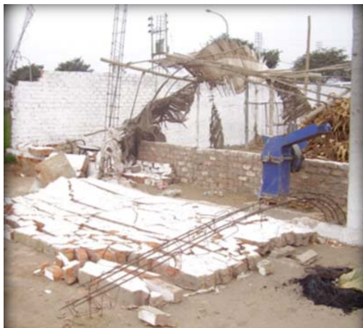
Figura 1.29 Fracturación y colapso de la mampostería 14
