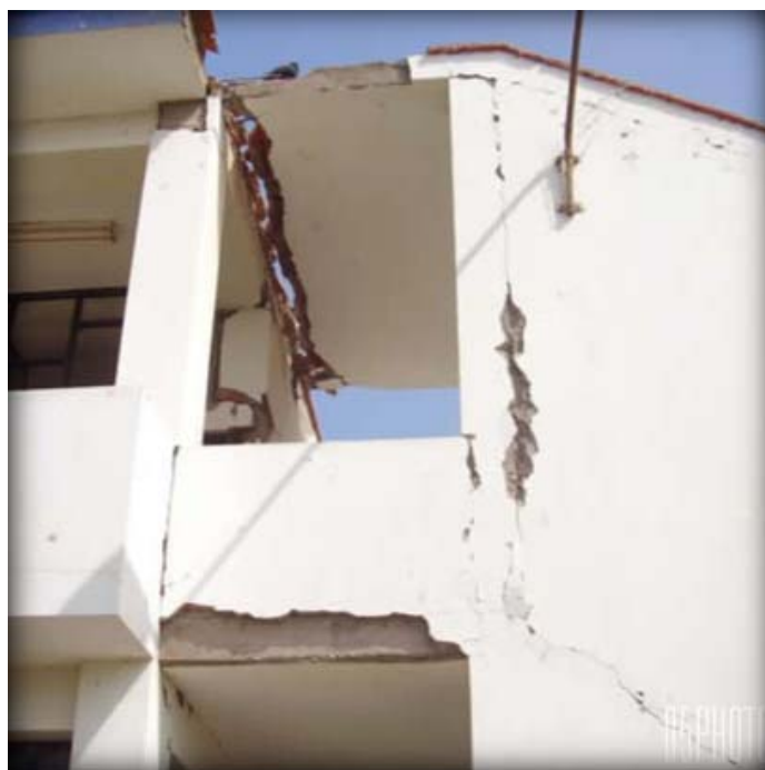
Figura 1.28 Fracturación de la mampostería y daños en elementos estructurales 13
