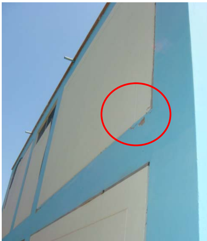
Figura 1.23 Daños en la unión columneta – viga principal 8
