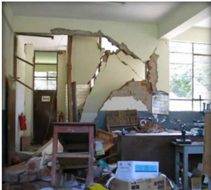
Figura 1.26 Fracturación de la mampostería 11
