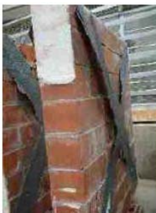
Figura 5.8 Desprendimiento de las láminas de FCRP 45
