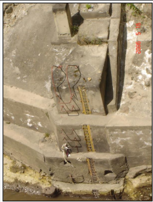
FOT. 49 REGLETA UBICADA EN LA MARGEN DERECHA DEL RÍO GUAYLLABAMBA SITIO DEL AFORO
