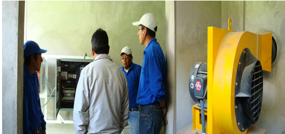
Imagen 2.3: Cuarto de Máquinas de la Piscina de Olas
