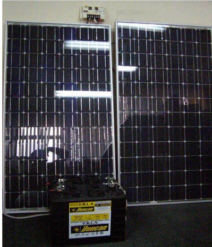
Figura. 5. 8. Equipos de la etapa de generación del sistema de respaldo de energía.
