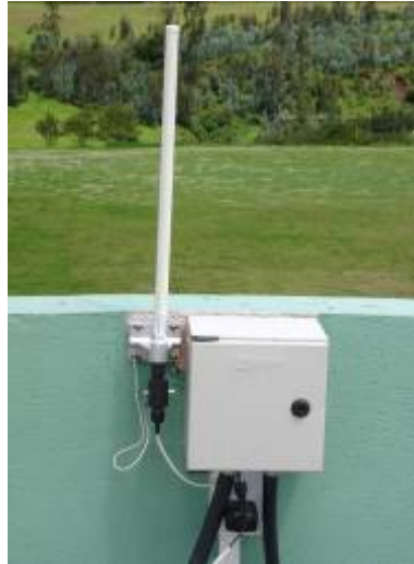
Figura. 7.24. Cajas para intemperie montadas con antenas para AP
