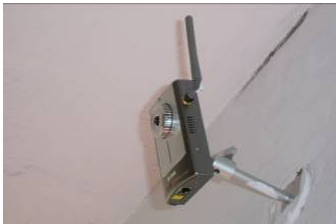
Figura. 7.75. Cámara DCS-2100G instalada
