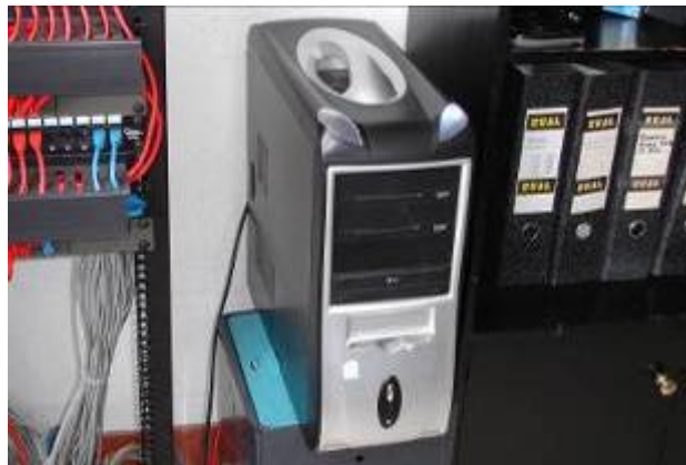
Figura. 7.2. Conexión del servidor de comunicaciones al patch panel de la red cableada
