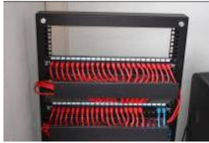
Figura. 7.1. Rack y patch panel de los nodos cableados.
