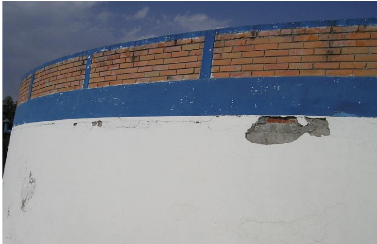
Foto 2.4: Tanque de reserva en mal estado
