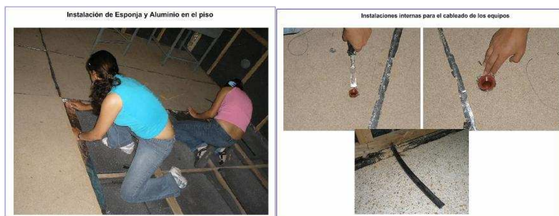
Figura. IV.28. Instalaciones en el piso de la Cámara
