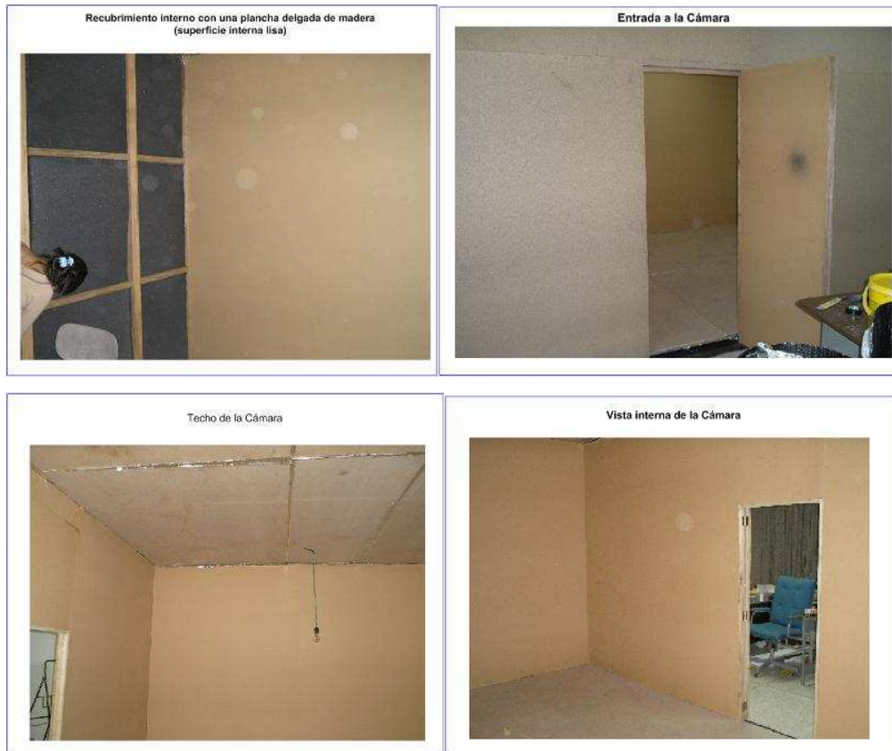
Figura. IV.30. Interior de la Cámara sin el material absorbente
