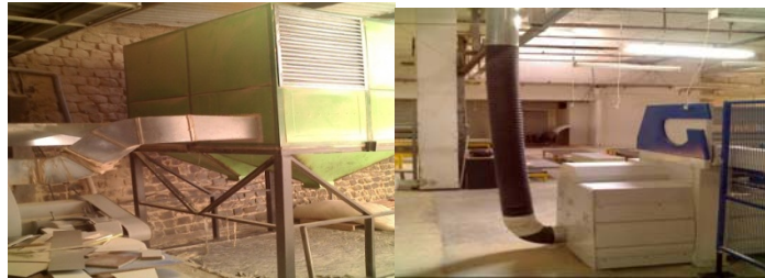
FOTOGRAFIA 5 Fotografía Extractor y conductos para el polvo y olores
