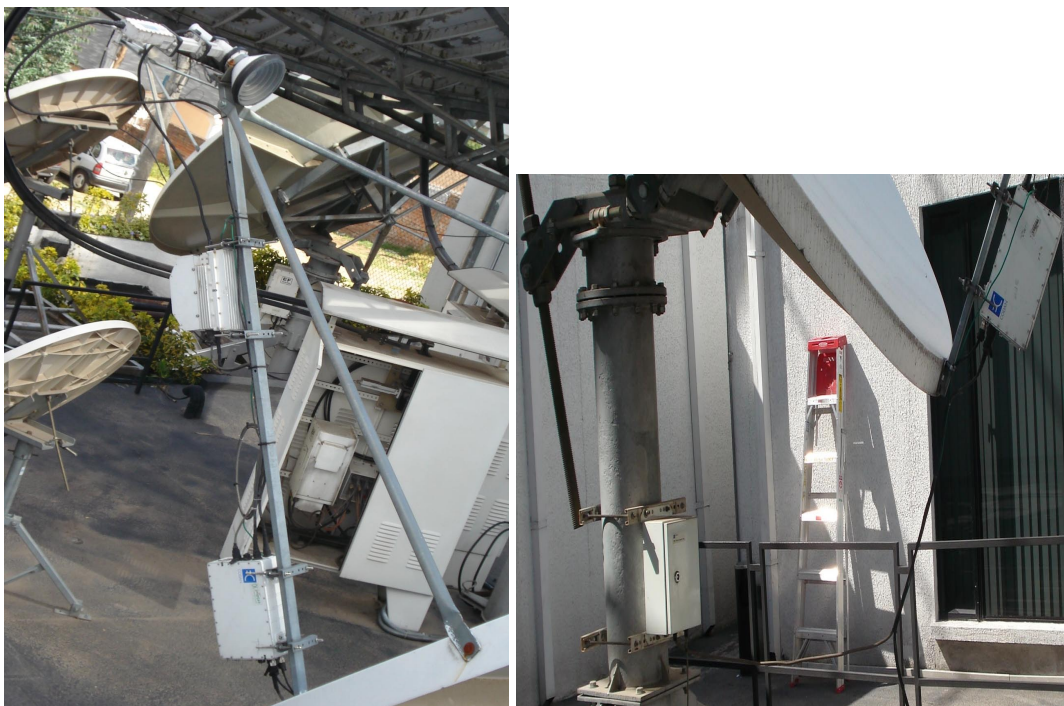
Figura. 2.70. Equipos Armados y listos para su configuración
