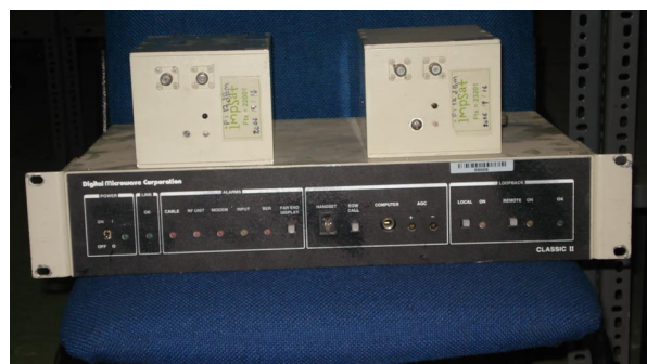
Figura. 1.55. Equipos DMC 23 Classic II Multirate
