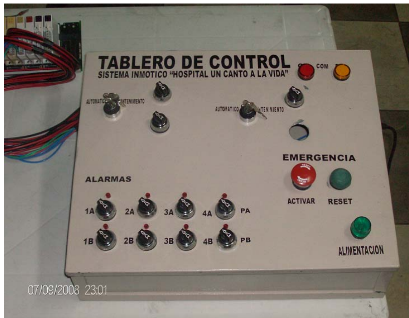
Figura 5.2 Tablero de control
