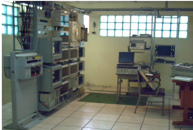
Figura. 5.1. Equipos Lago Agrio
