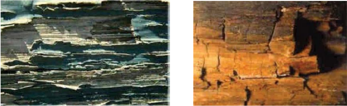
Figura 2.18 Piezas de madera atacadas por hongos de pudrición
