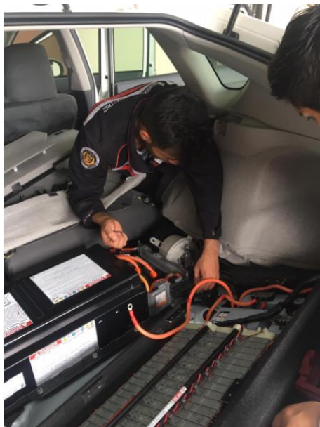
Figura 27. Instalación de la batería de módulos cilíndricos en la parte posterior del vehículo híbrido
