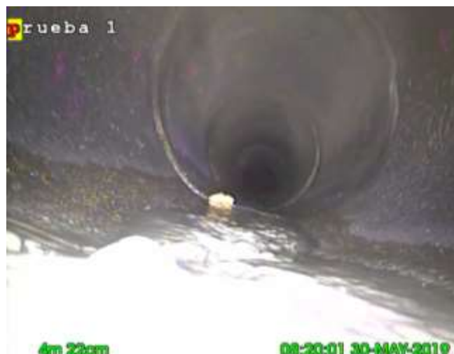
Figura 37. Presencia de grietas en las uniones de las tuberías
