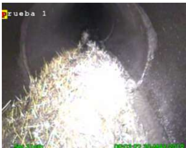
Figura 42. Presencia de raíces en el interior de tramo de tubería entre los pozos 38 y 41
