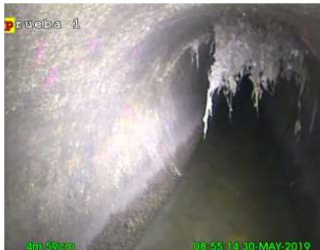
Figura 39. Presencia de raíces en tramo de tubería. Pozos 37 y 36
