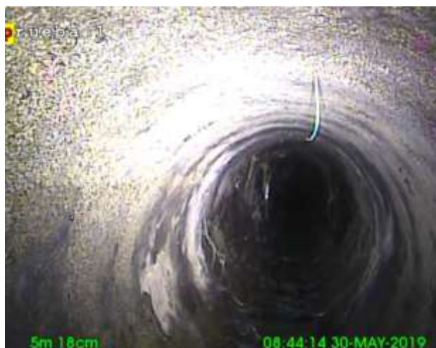
Figura 40. Tramo de tubería en mal estado. Pozos 64 y 65
