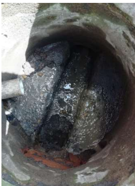
Figura 29. Pozo N° 84. Residuos sólidos en pozo de revisión
