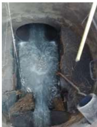
Figura 30. Pozo N° 81. Presencia de raíces en su interior
