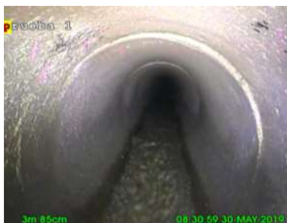
Figura 38. Tubería agrietada tramos entre los pozos 55 y 56
