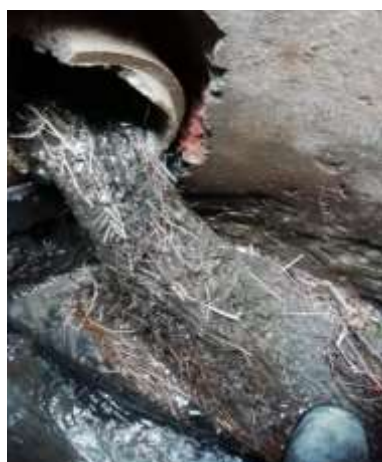
Figura 31. Pozo N° 133. Presencia de raíces en la tubería
