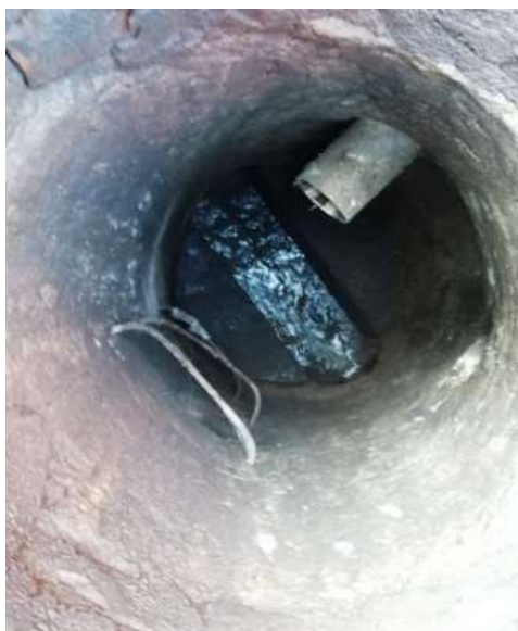
Figura 28. Pozo N° 120. Acometida Domiciliaria
