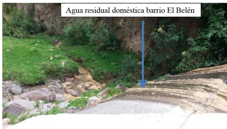
Figura 5. Colector agua residual barrio El Belén
