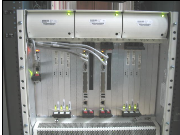
Fig. 2.3-11 Fotografía del Servidor Telefónico del FE de la Central TDQ2
