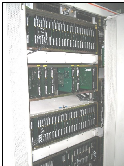
Fig. 2.3-3 Fotografía del Punto de Comutación del Servicio (SSP)
