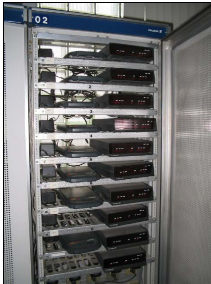
Fig. 2.4-12 Fotografía de Modems para conexión con las centrales ERICSSON
