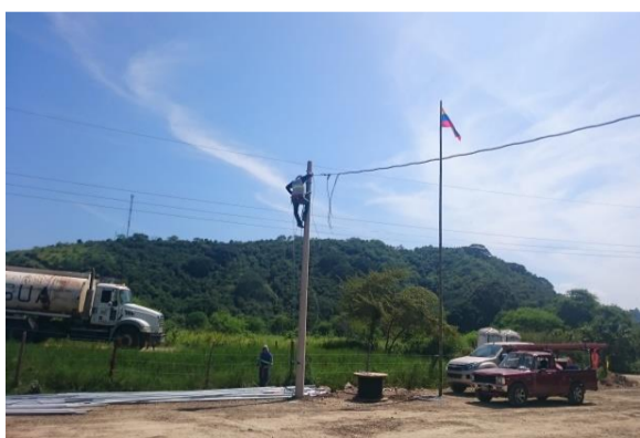
Figura 50. Red de postes aéreos colocados en el interior del albergue.
