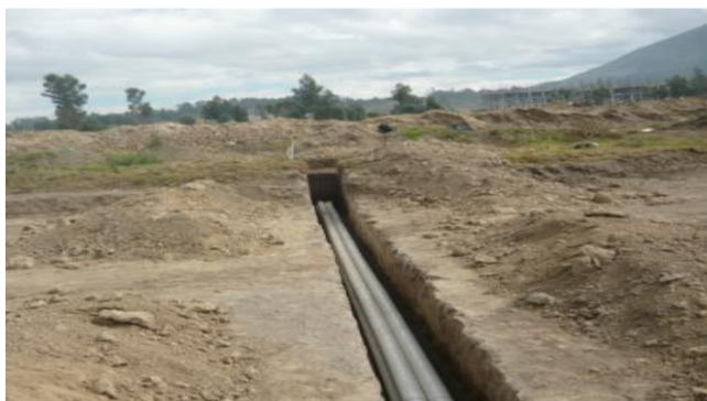
Figura 48. Ductos de PVC que sirven para proteger a los cables eléctricos.
