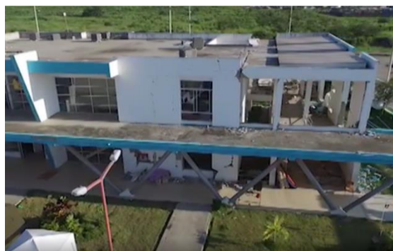
Figura 13. La Unidad educativa del Milenio de Pedernales después del sismo
