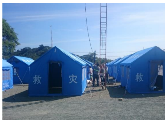
Figura 51. Instalaciones eléctricas para cada una de las carpas.
