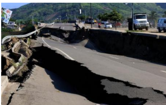
Figura 32. Daños en las carreteras producidos por el evento sísmico.
