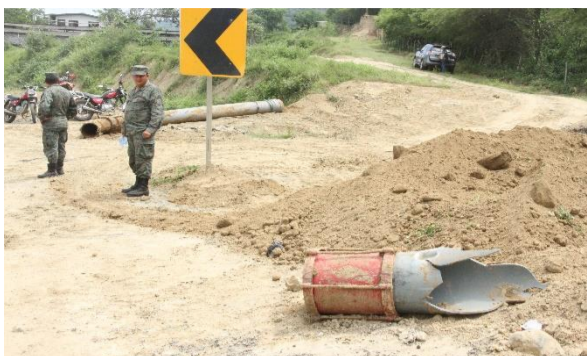
Figura 42. Tuberías del sistema de agua potable dañadas por el sismo.
