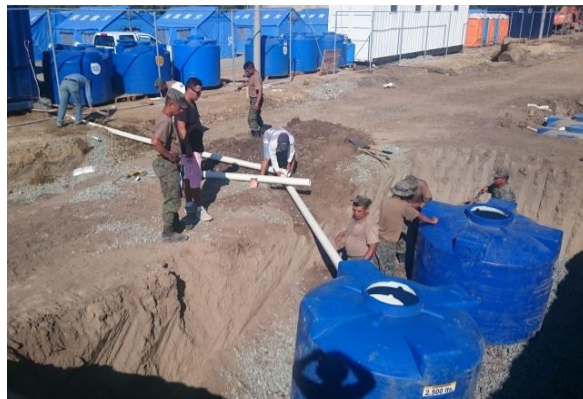
Figura 41. Tanques sépticos del sistema de alcantarillado.
