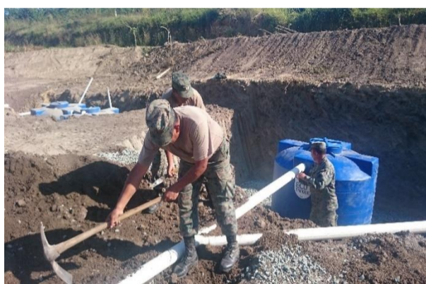
Figura 69. Tanques de aguas servidas
