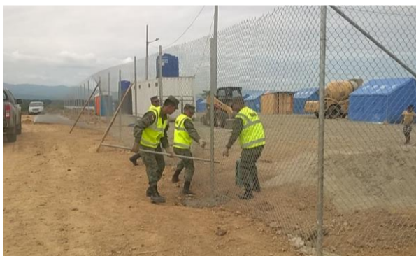
Figura 54. Tubos galvanizados que sirven como postes del cerramiento.
