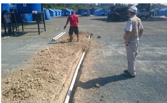
Figura 44. Tuberías de PVC del sistema de agua.
