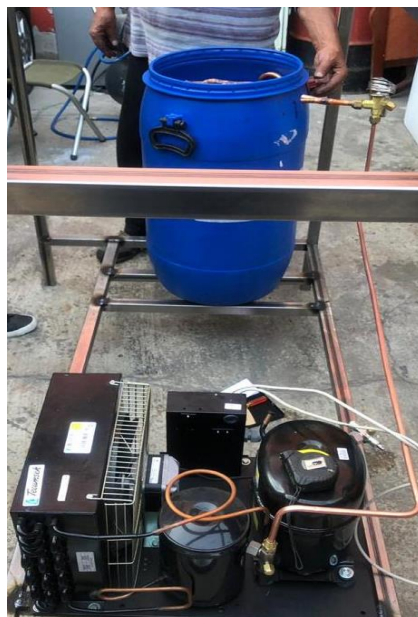
Figura 45. Sistema de refrigeración
