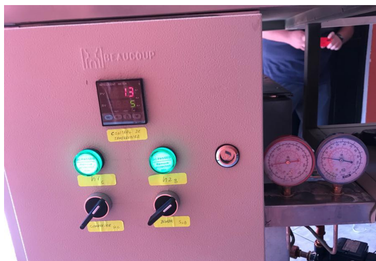
Figura 48. Panel de control ON/OFF de sistema de refrigeración y bomba
