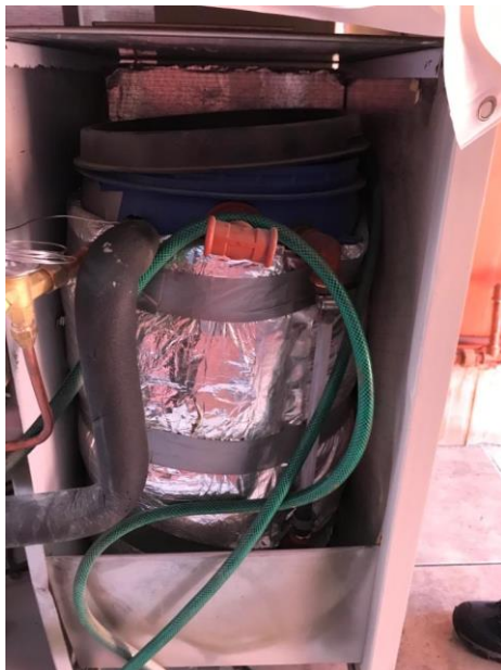
Figura 46. Aislamiento del tanque de almacenamiento
