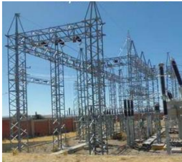
Figura 3. Pórticos en la S/E de Babahoyo
