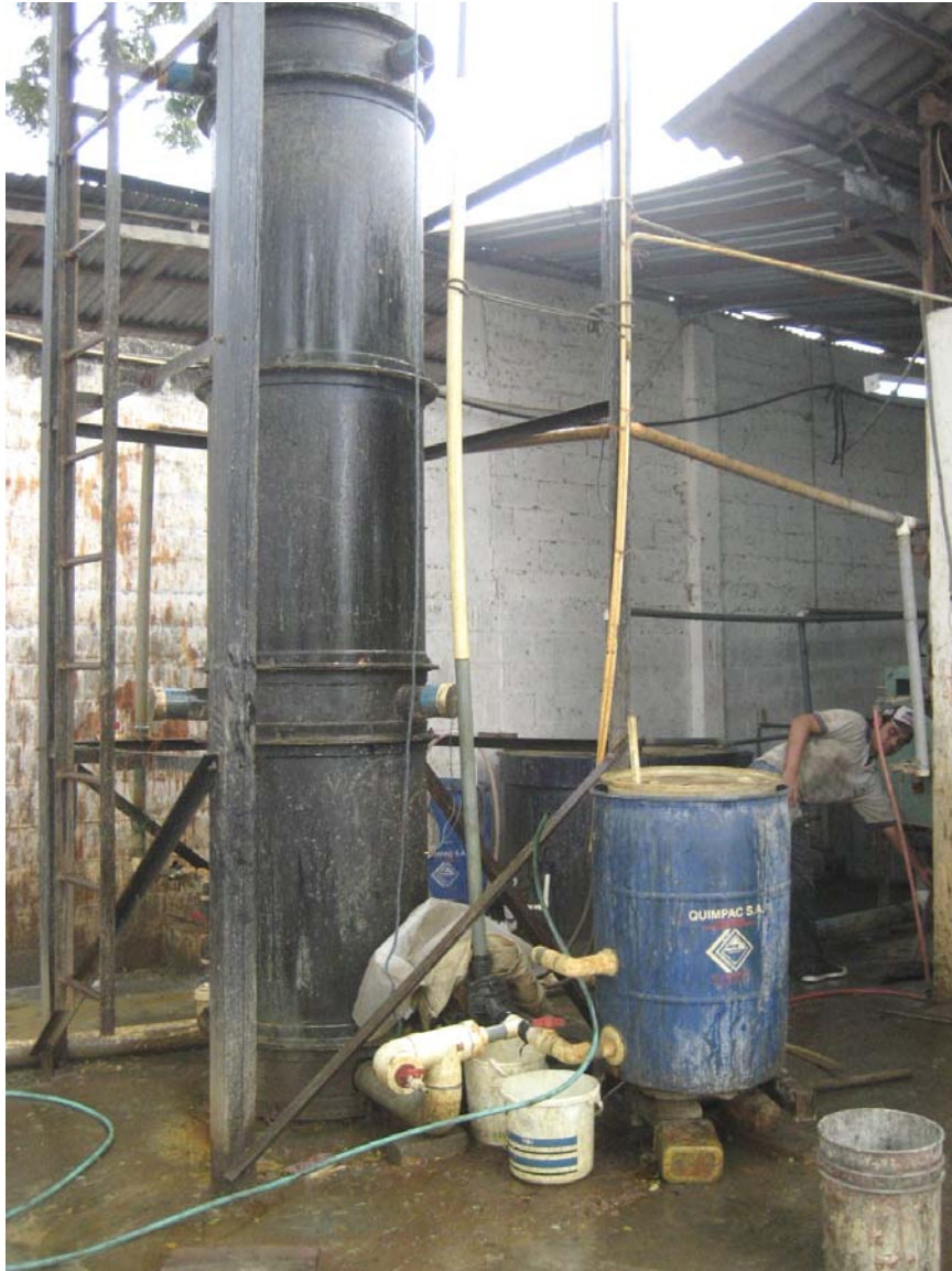
Torre de biolixiviación de la Empresa Minera Orenas S.A.
