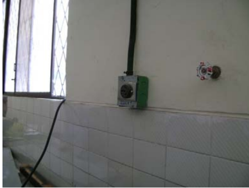
Figura 4.12 Toma principal de energía
