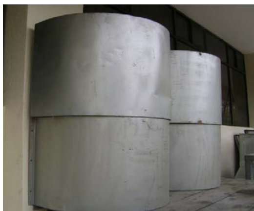
Figura 3.8 Ductos de rotación de aire
