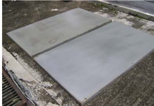
Figura 3.9 Tapas aislamiento intercambiadores
