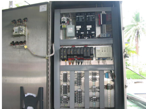
Figura F10. Armario de control
