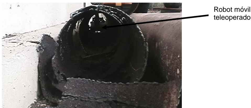
Figura. 6.2. Tuberías en pésimo estado con alto grado de irregularidad
