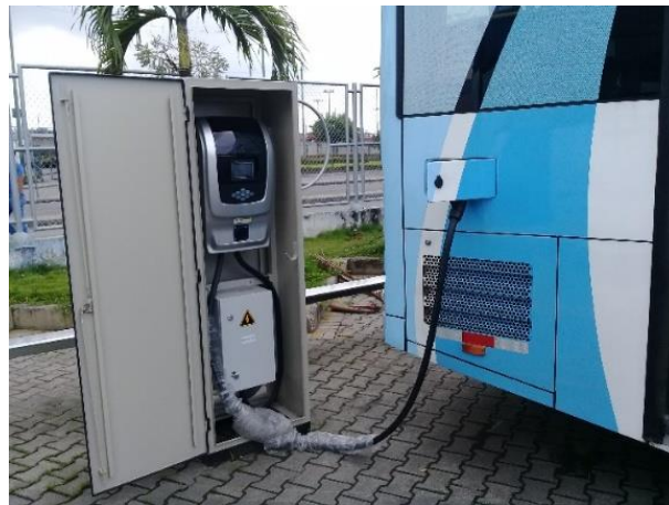
Figura 15. Carga de los buses eléctricos con el cargador de 40 KW
