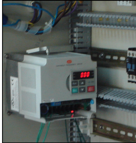
Figura. 5.4. Variador de velocidad
