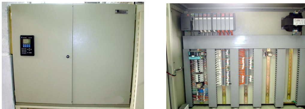
Figura 5.7. Ubicación del tablero de control
