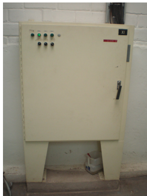
Figura. 3.3. Tablero de Control de los Hornos
