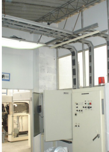
Figura 5.9. Soportería de cableado
