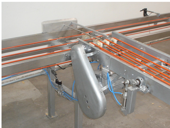
Figura 5.3. Motor para accionamiento de la banda de salida del horno 2
