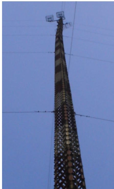
Figura. 4.1. Torre desviada de Limoncocha.
