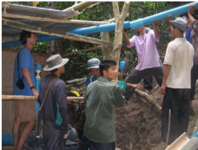
Figura 1.4 Instalaciones Exteriores en Campo
