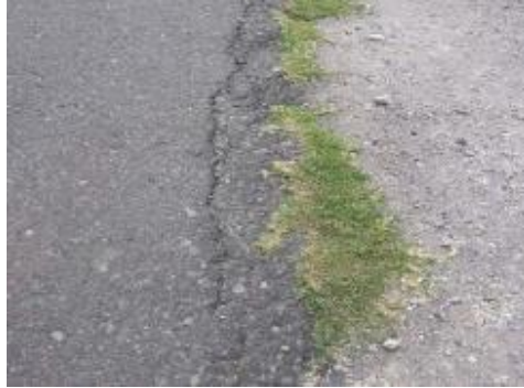
Fisuras de borde
