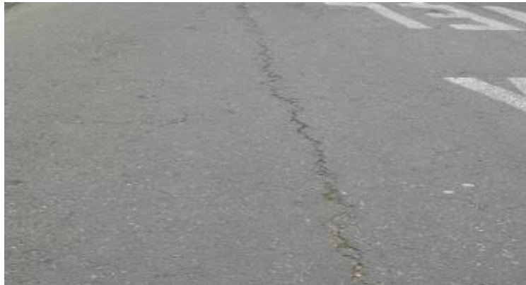
Fisura Longitudinal de un pavimento flexible
