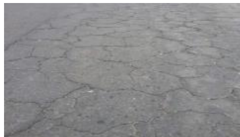
Fisuras de bloque
