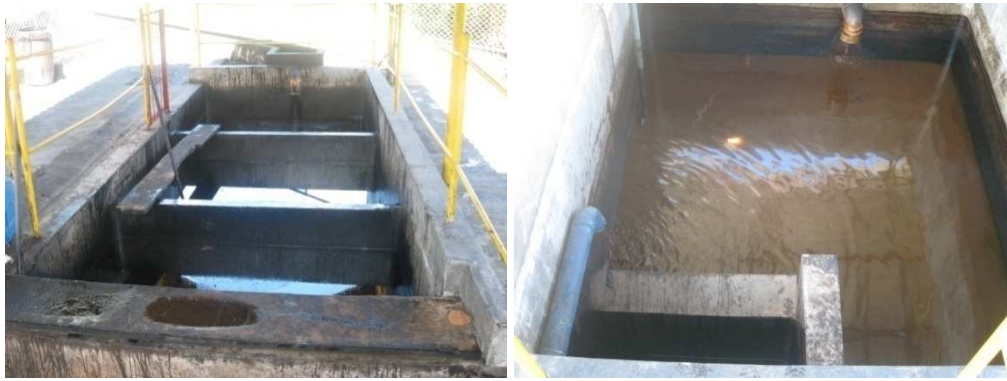
Figura 2.1. Piscinas de sedimentación primaria
