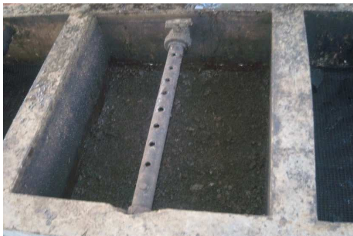
Figura 3.4. Depósito de lodos
