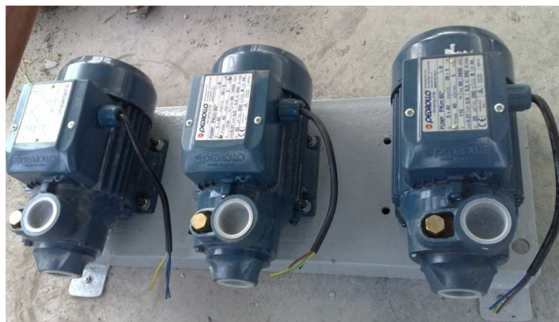
Figura 5.1. Bombas de 1 ½ HP.
