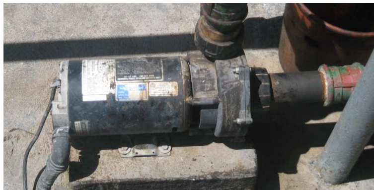
Figura 5.2. Bombas de 2 HP.
