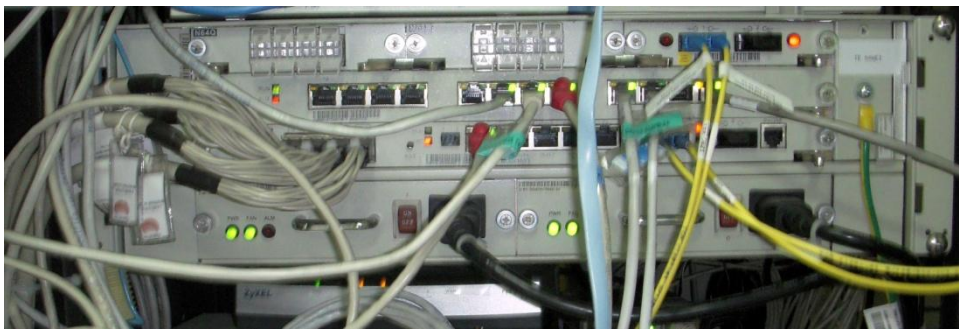
Figura. 3.7. Fotografía del equipo Huawei Optix Metro 1000.
