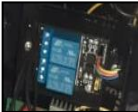
Figura 67. Relé de control paro de emergencia.
