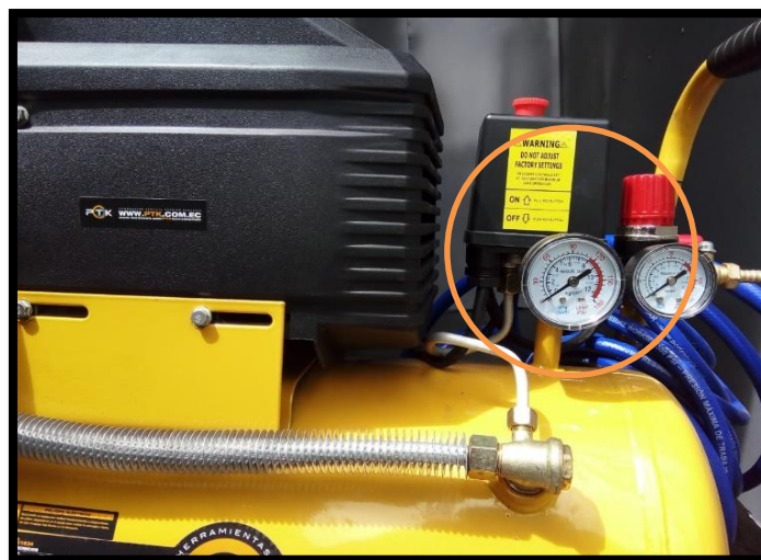
Figura 36 Compresor apagado totalmente descargado.
