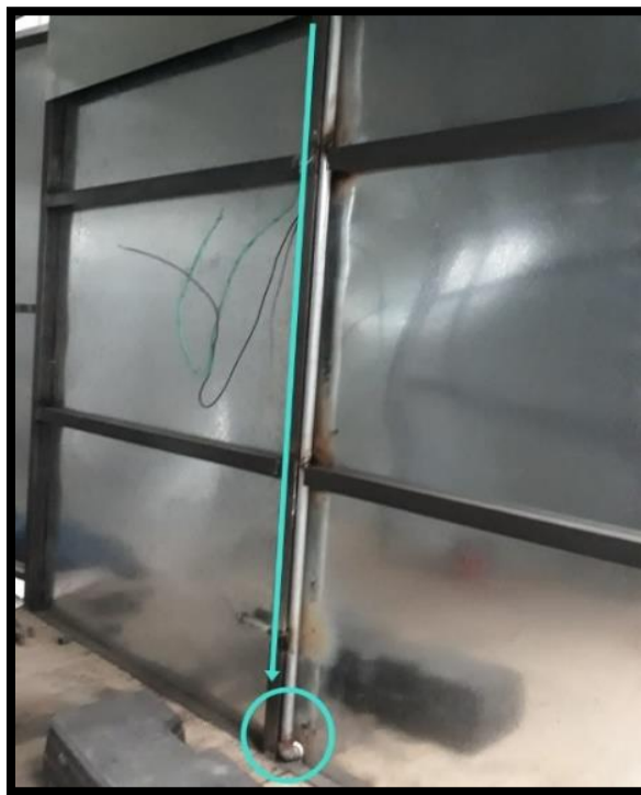
Figura 34 Inspección visual de los puntos de enlace entre nuestras líneas de aire.
