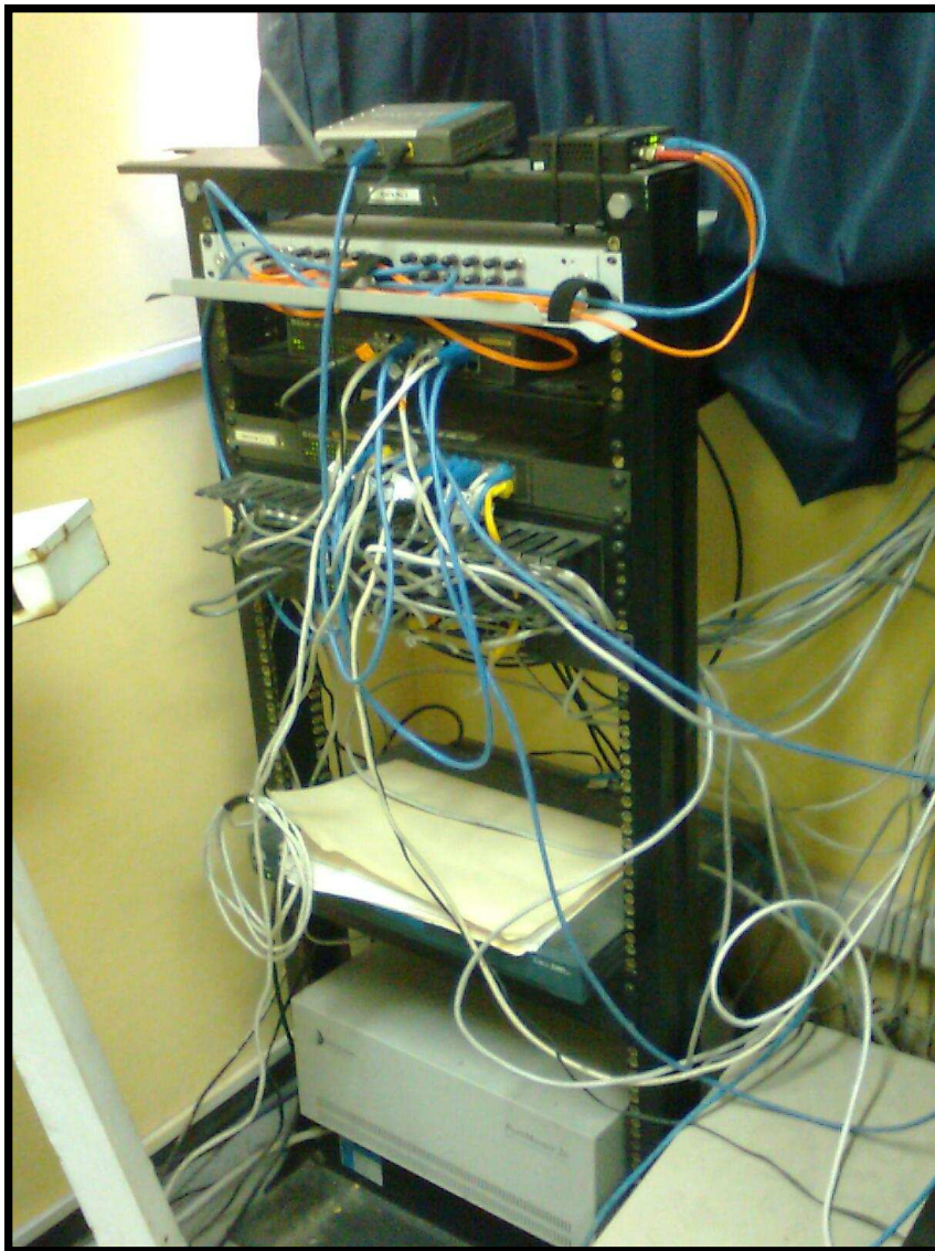
Fig. Nº 02. Estado actual de las conexiones con los servidores de internet en la dependencia Sistemas de Comunicación (SICOM).
