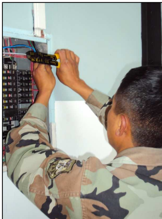
Fig. 3. 1 Conexión eléctrica para energizar el letrero.
