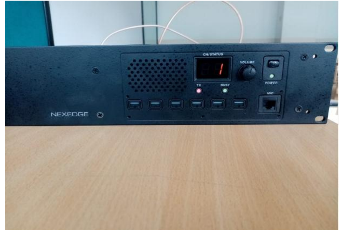
Recepción de la señal en la repetidora
