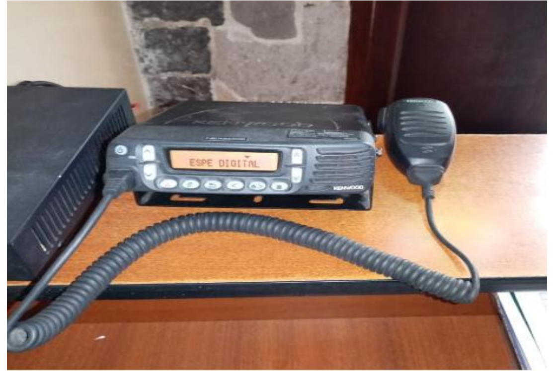
Estación base ESPE CENTRO
