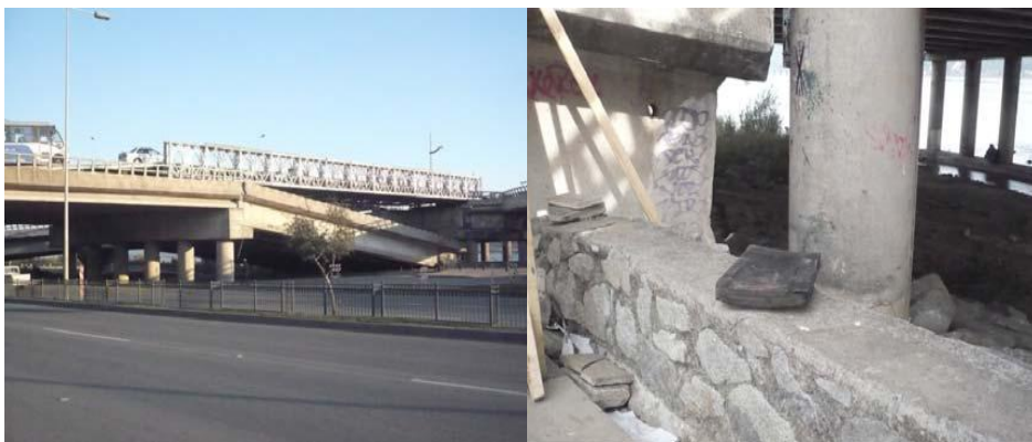
Fig.3.8. Colapso de vigas "Neoprenos sin trabajar" (Aguiar 2010)
