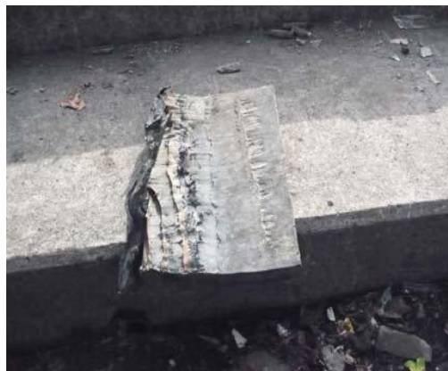
Fig. 3.7. Desgaste del neopreno (Aguiar 2010)
