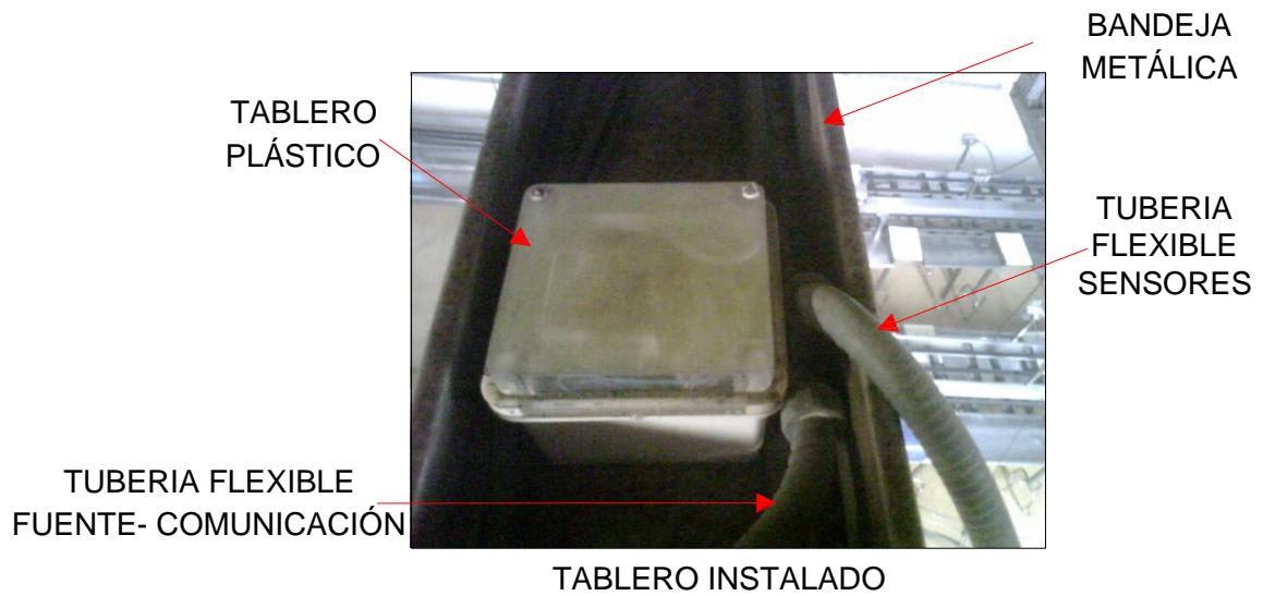
Figura. 5. 8. Tablero instalado vista externa
