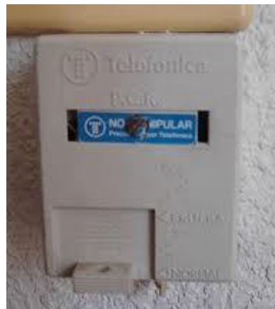
Figura 1. 2. Punto de Terminación de Red (PTR)
