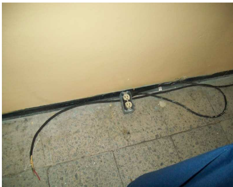
Fotografía 3.1. Cable y tomacorriente sin protección- Departamento de Archivo General, Registro, Titulación, Certificación, Acreditación y Matrícula
