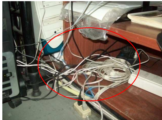
Falta de orden y limpieza
