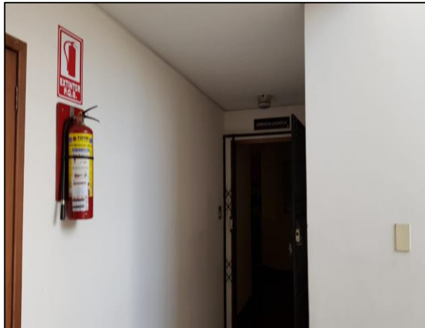
Figura 35 Extintor PQS pasillo tercer piso.
