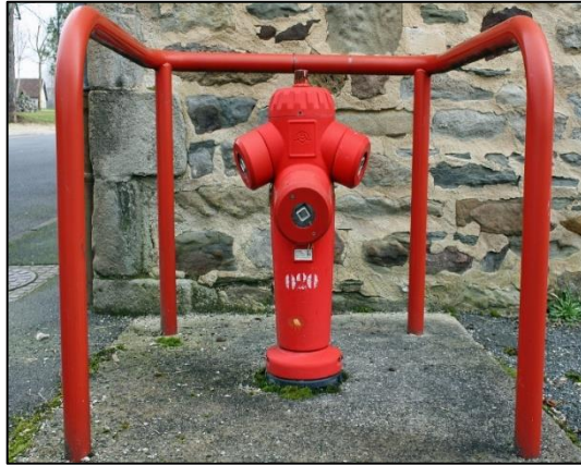
Figura 16 Hidrante de incendio.
