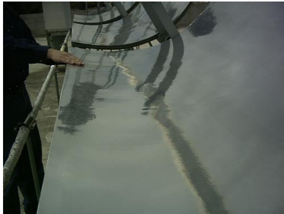
Figura 6.56. Película reflectante colocada sobre la superficie interior del concentrador.
