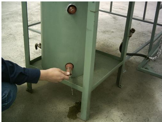
Figura 7.25. Tanque de calentamiento lleno de agua.
