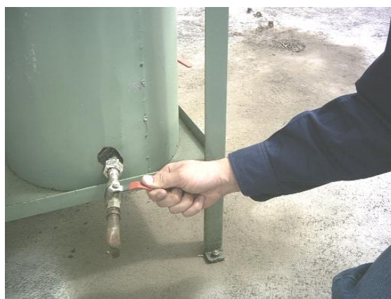
Figura 7.24. Válvula de globo de la tubería de conexión a la bomba.
