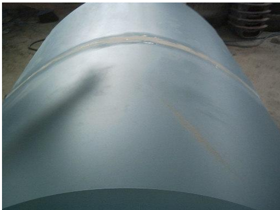
Figura 6.21. Cavidad que se presenta entre las láminas de las láminas de aluminio.
