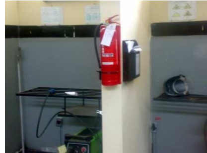
Extinguidor de fuego
