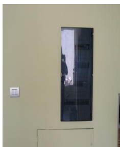
Figura. 3.8. Tableros Domóticos Terminado
