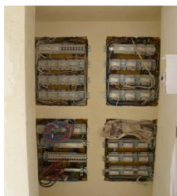
Figura. 3.7. Tableros Domóticos – Residencia Racines en Puenbo
