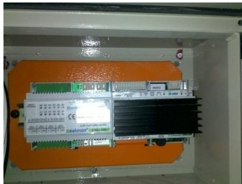
Figura 5.16. Nodos dentro de la caja Inmótica
