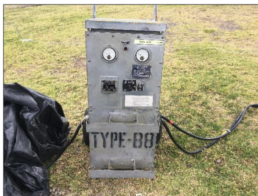
Figura 29. Generador eléctrico de tierra
