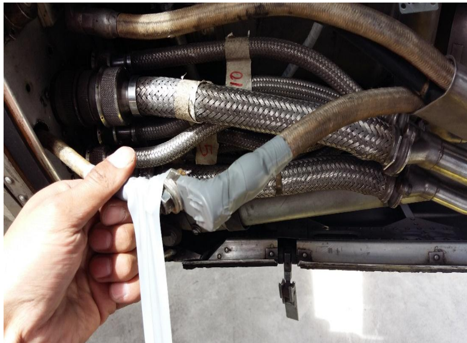
Figura 32 Aislamiento Cables P6N2A
