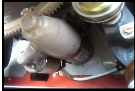
Sujeción de los diferentes conjuntos de cables al motor
