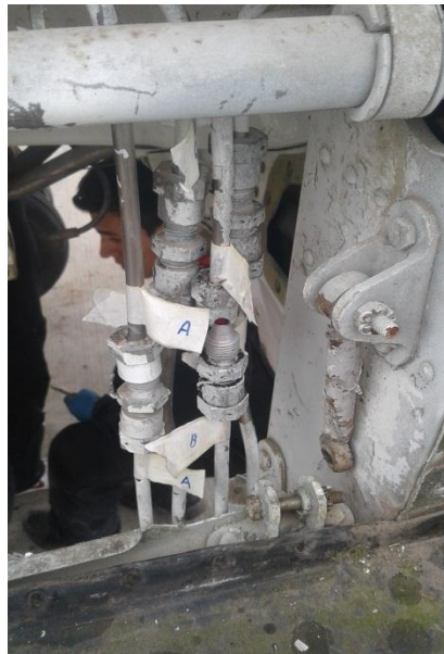
Figura 41 Identificación de las cañerías hidráulicas
