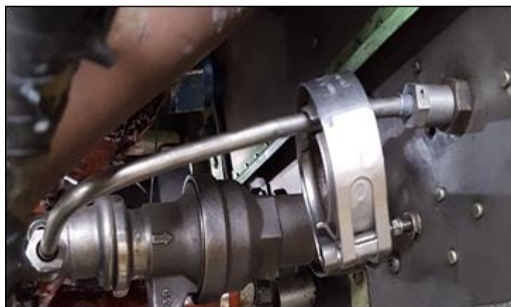
Figura 27 Línea de purga de aire desconectada
