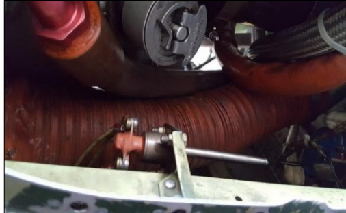
Figura 19 Detector de incendios
