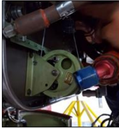
Figura 23 Líneas de alimentación y de purga de combustible
