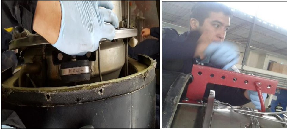
Figura 28 Remoción del montante superior del motor y colocación de la herramienta tipo L para el izaje del motor
