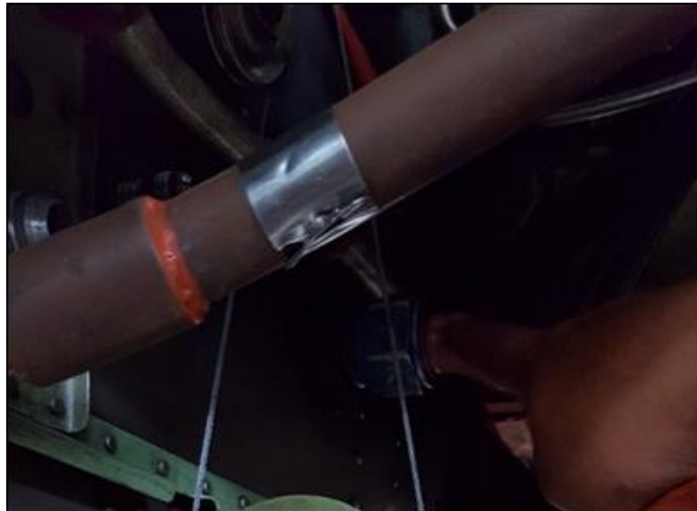
Figura 26 Línea de aceite conectada en la pared de fuego
