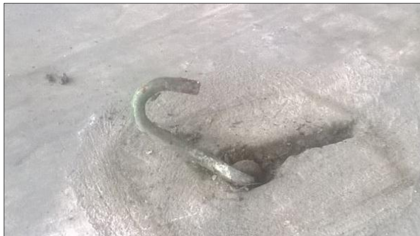
FIGURA 20 Gancho de anclaje en el suelo del hangar
